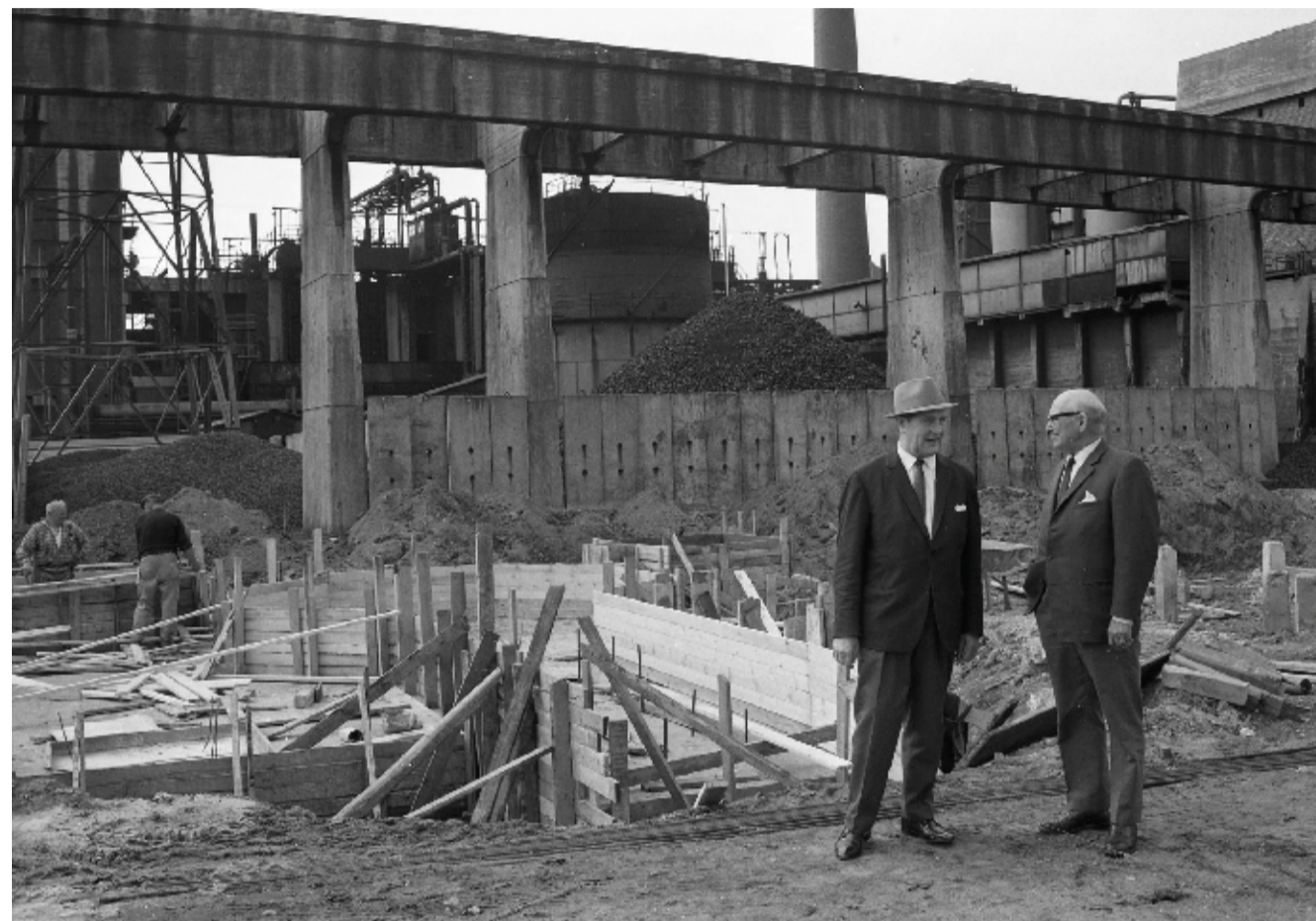
I 1968-69 blev det nye spaltgasværk opført, og kulbroen i baggrunden blev dermed overflødig, idet kranen på broen ikke længere skulle bruges til at skovle kul og koks. Fotograf: Ib Rahbek-Clausen, 1968, Århus Stiftstidende, Rigsarkivet Aarhus, leveret af Aarhus Stadsarkiv.
