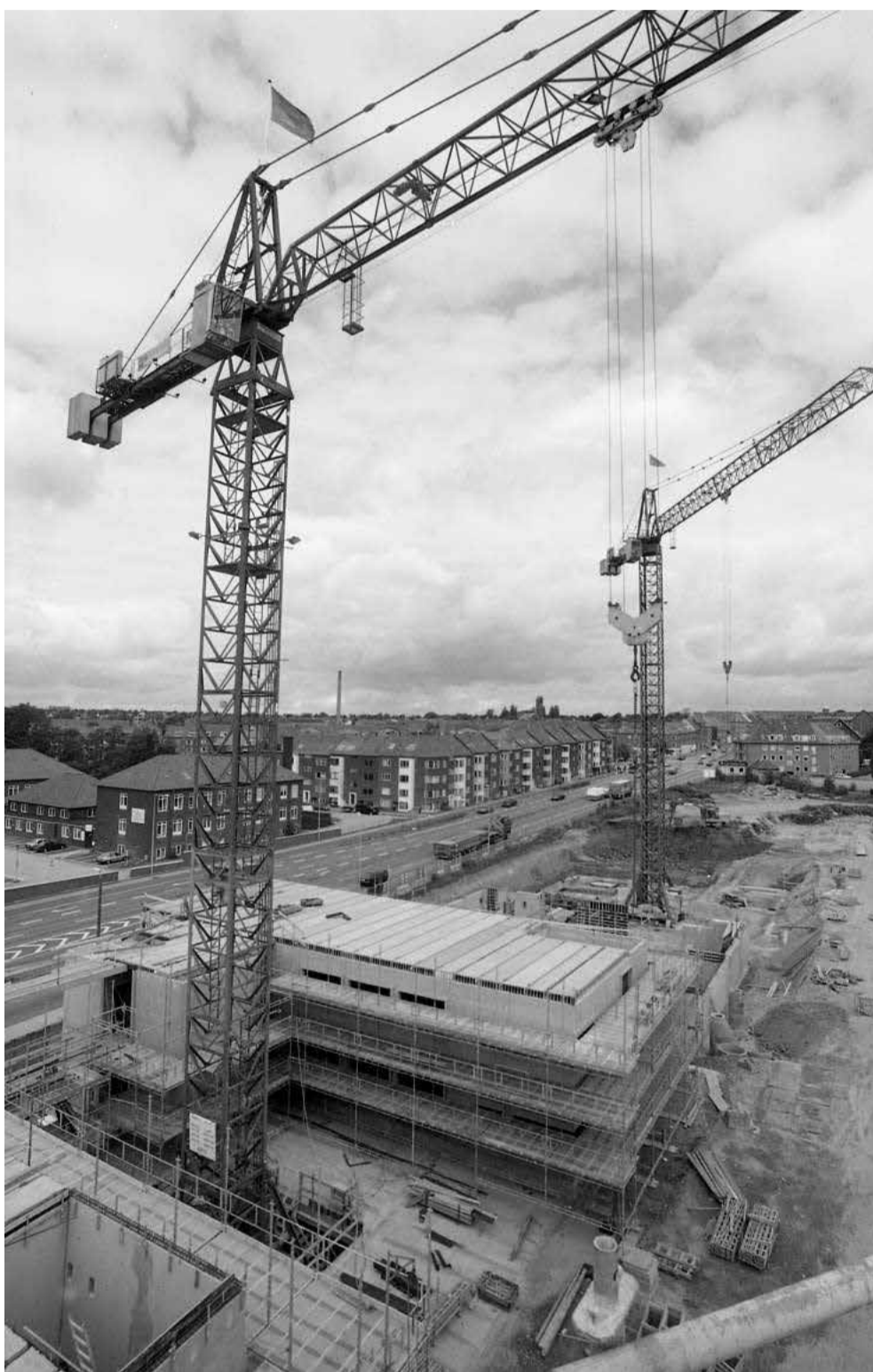
Nobelparken under opførelse i 1998. På dette sted lå den kendte Aarhus Tømmerhandel, også kendt som Barnow. Foto: Jens Tønnesen, 1998, Aarhus Stadsarkiv.
