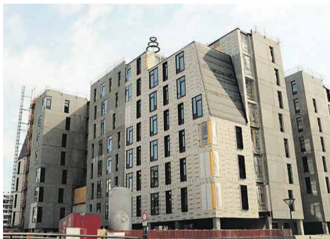
30. april 2019 var der rejsegilde på Generationernes Hus, hvor både håndværkere, kommende beboere og andre interesserede var mødt op. Foto: Sundhed og Omsorg, Aarhus Kommune
